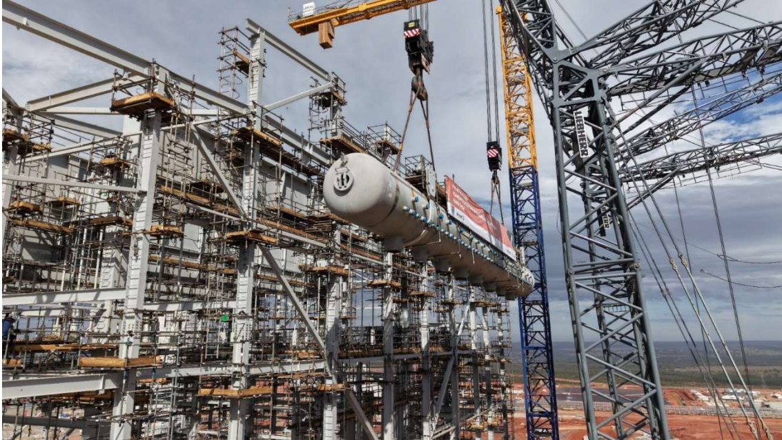
Arauco conclui o içamento do balão de vapor na maior caldeira de recuperação do mundo. Foto: Divulgação/Arauco.
