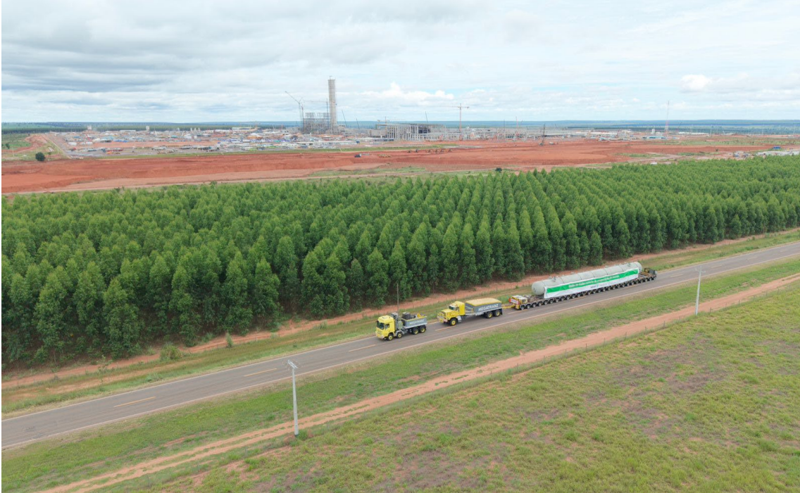
Balão da Caldeira de recuperação do Projeto Sucuriú - Créditos: Arauco
